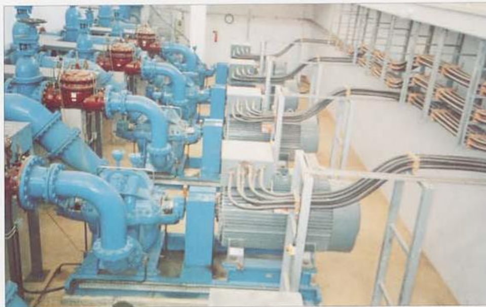
Αντλιοστάσιο Τερσεφάνου - Tersephanou pumping station
